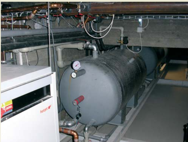
Zásobníky teplé vody
