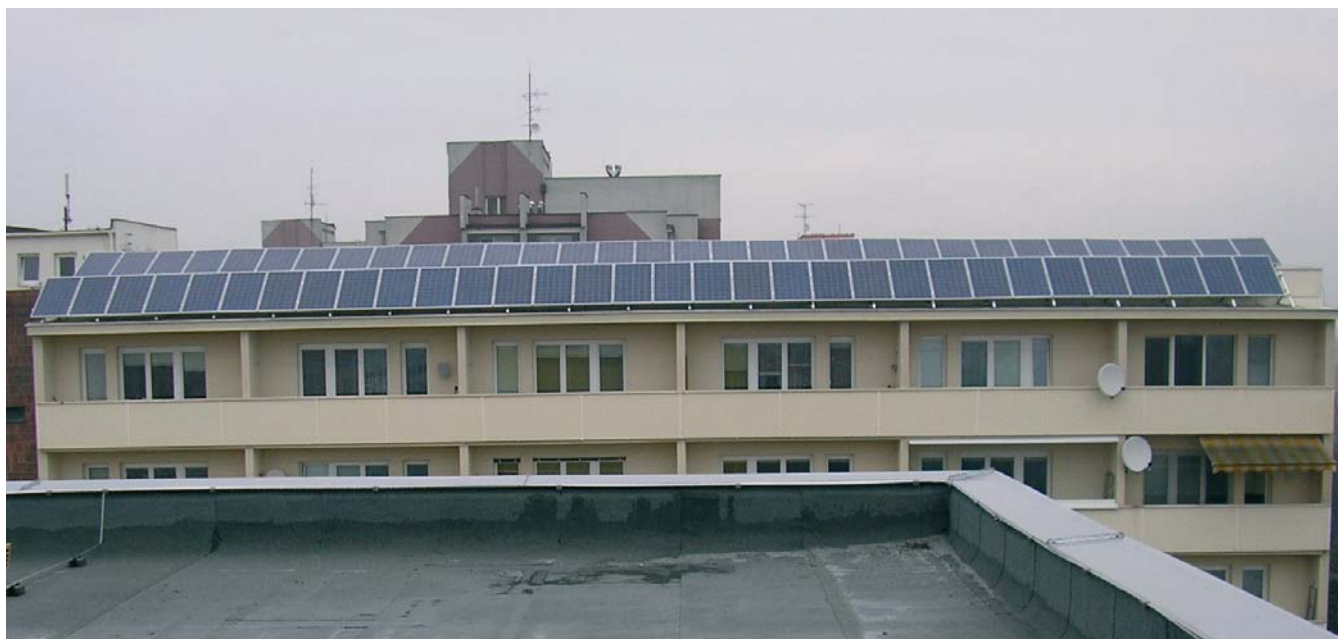
Panely fotovoltaické elektrárny na střeše našeho domu
