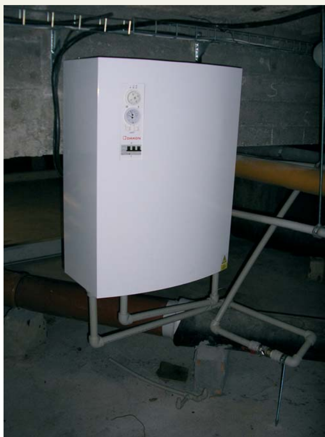
Záložní zdroj tepla - přímotopný kotel Dakon
