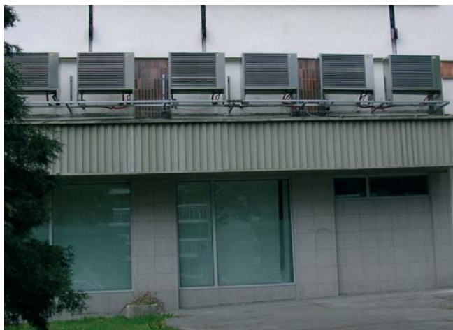
Venkovní část tepelných čerpadel
