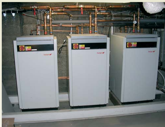
Srdce naší kotelny: tepelná čerpadla
